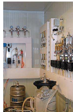
Blick in den Kühlraum. Von hier aus werden Getränke frisch gezapft.
