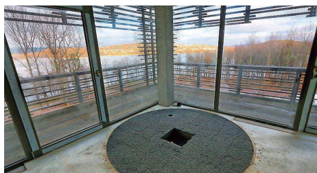
Der Steinboden, auf dem die runde, freistehende Badewanne montiert wird, ist bereits verlegt. Es fehlt nur noch die Wanne.
